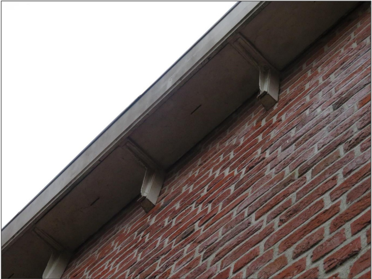
Afb 13: Aansluitingen metselwerk met goten sluiten strak aan
