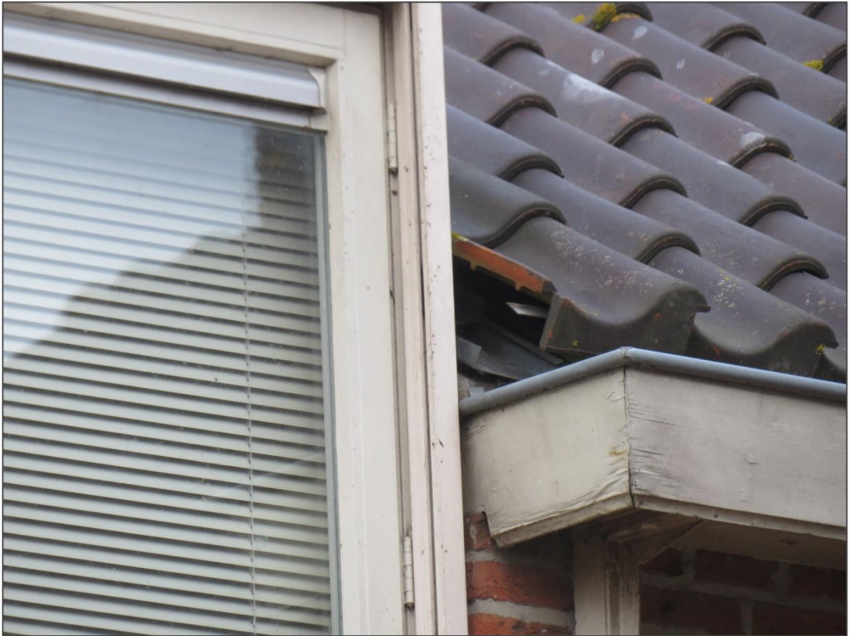
Afb 10: Hier een opening waardoor vogels naar binnen kunnen
