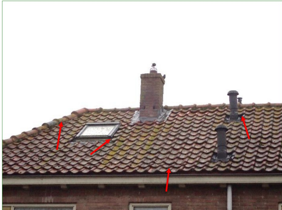
De openingen onder de dakpannen (rode pijlen) van de bebouwing geven mogelijk toegang tot voor Huismus en/of Gierzwaluwen geschikte achterliggende ruimtes.
